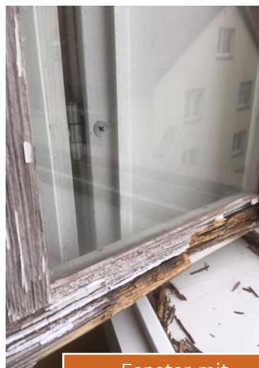
Fenster mit Beschädigung
