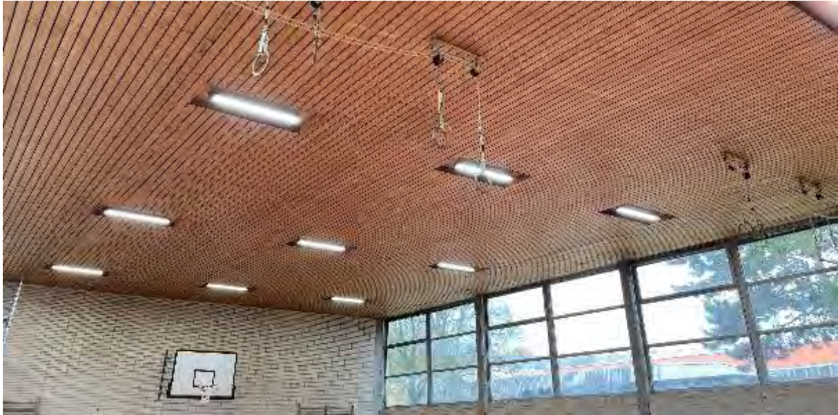
Abbildung 23: Beleuchtung in der Kurt Schuhmacher Schule
