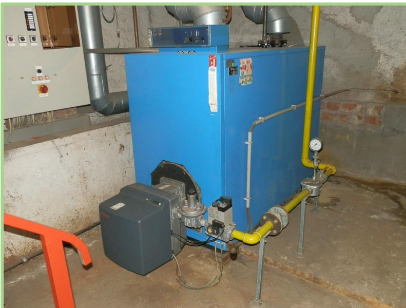
Georg-August-Zinn-Schule / Heizraum Altbau
